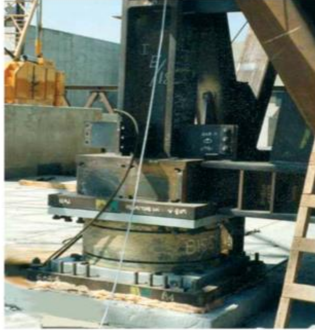
Şekil 3.6 Çelik kolon altına yerleştirilmiş izolatörler [33]
