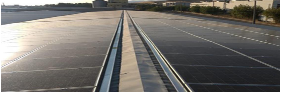
Resim 2.4 Çatı güneş enerji santrali [25]
