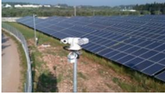
Resim 3.40 Güneş enerji santrallerinde kamera sistemi
