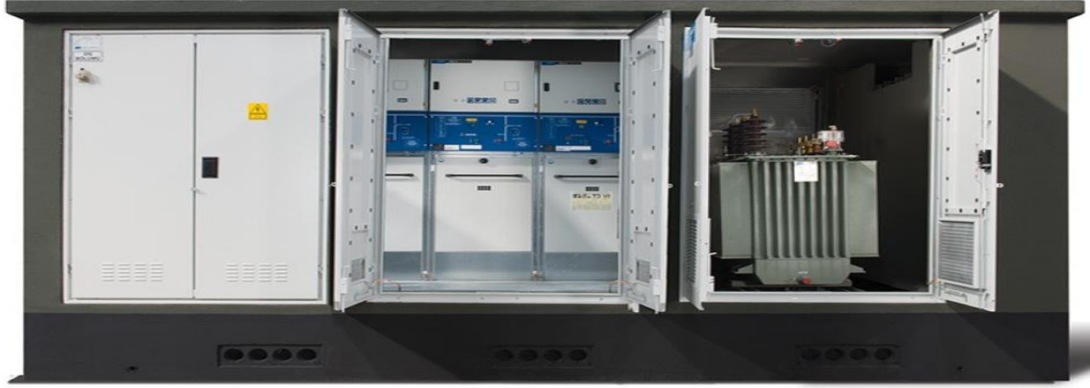
Resim 3.29 Örnek Trafo Köşkü [53]
