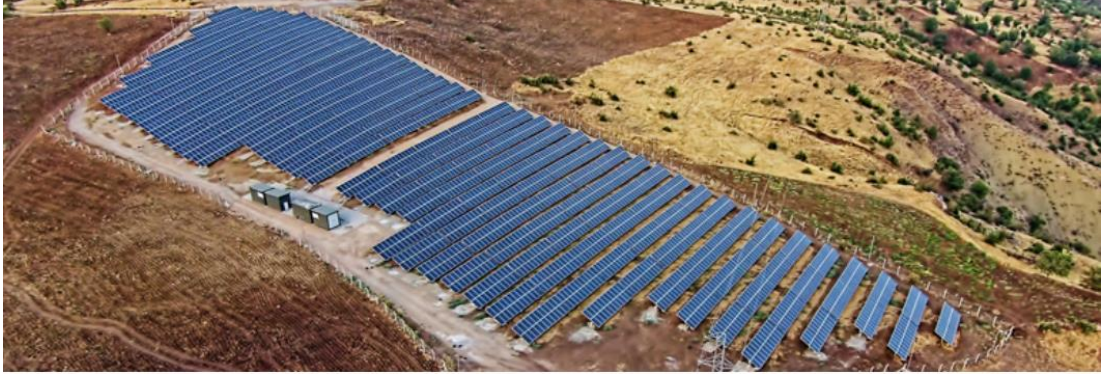
Resim 2.3 1MWzemine monteli güneş enerji santrali [24]
