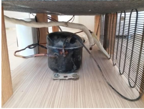
Şekil 3.6 Kompresör ve kondensere ait görseller
