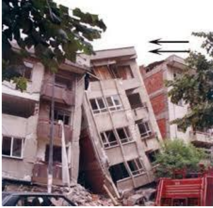
Resim 1.1 17 Ağustos 1999 Marmara depreminde yan binanın çekişleme etkisiyle devrilen bina [1]
