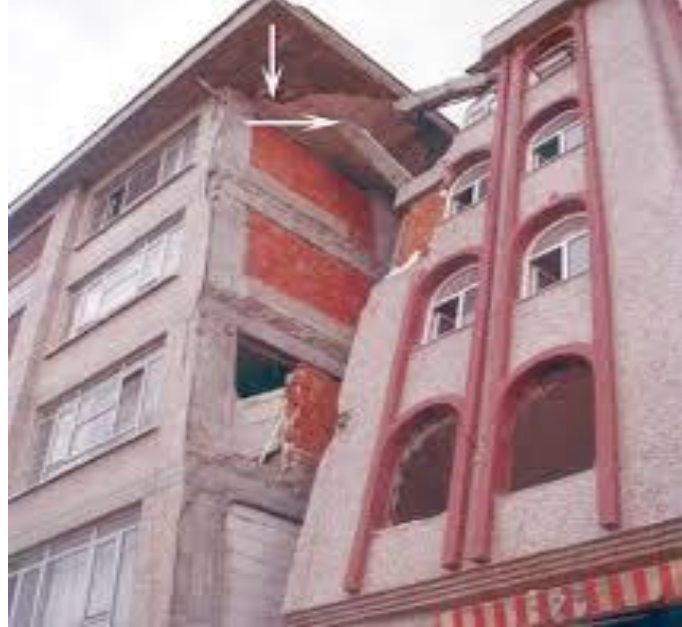
Resim 1.2 Depremde binalar arasında oluşan çekişleme etkisi [2]
