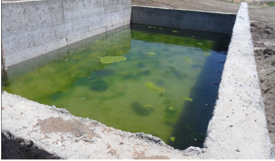
Resim 4.4 Firma02 çöktürme havuzu görüntüsü
