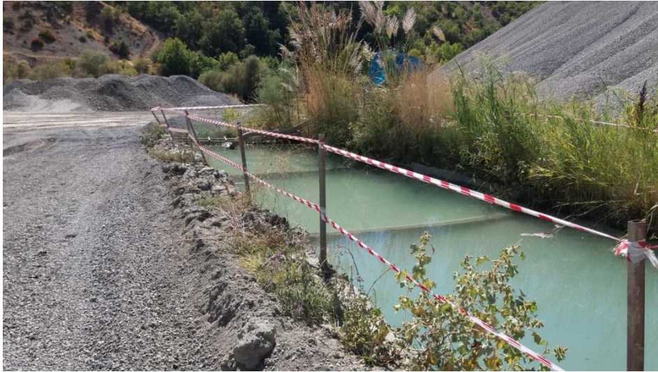
Resim 4.8 Firma05 çöktürme havuzu görüntüsü
