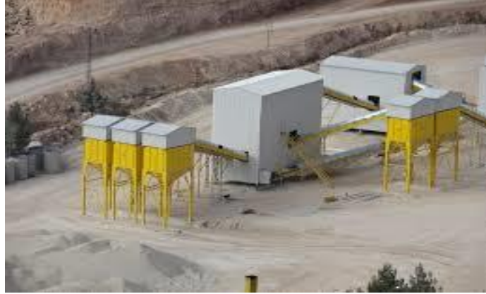
Resim 1.2 Kırma-eleme tesislerinde kullanılan üzeri kapalı taşıyıcı bant örneği
