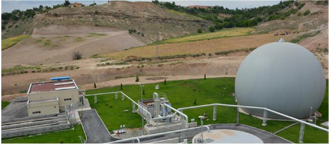
Şekil 5.14. Biyogaz depolama balonu
