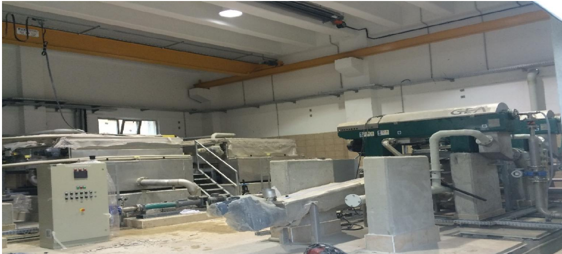
Şekil 5.15. Çamur yoğunlaştırma ve susuzlaştırma ünitesi
