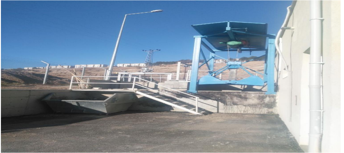
Şekil 5.3. Giriş pompa istasyonu ve kaba ızgara
