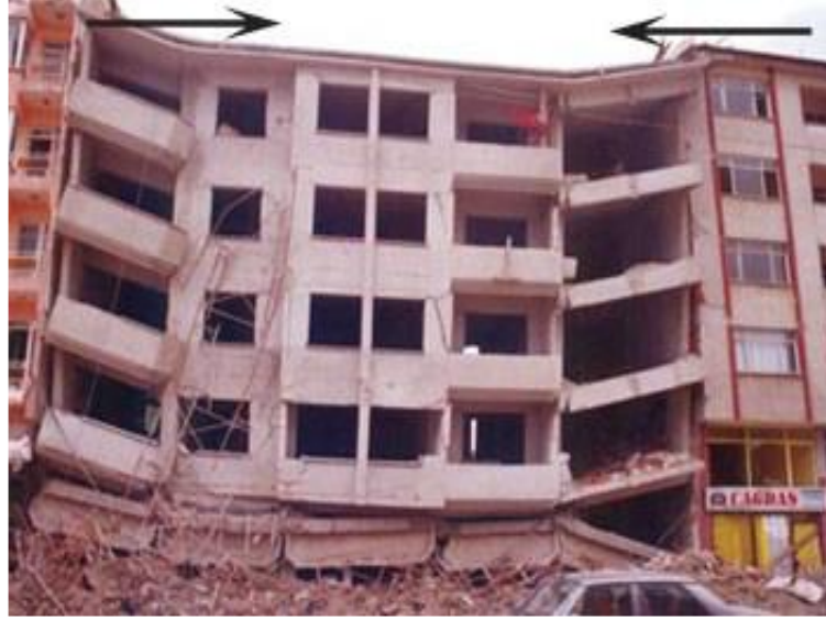
Şekil 2.18. Zayıf kat ve çarpışma sebebiyle içteki binada meydana gelen hasar
