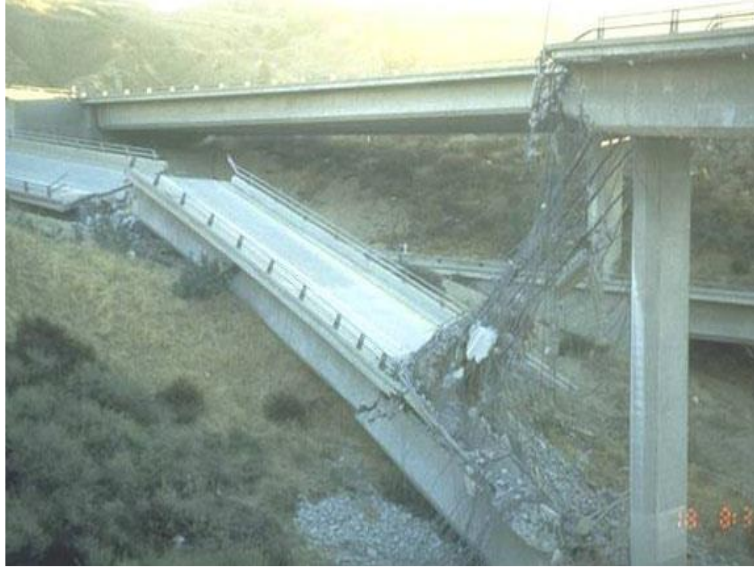
Şekil 2.4. Northridge depremi sonrası hasar örneği
