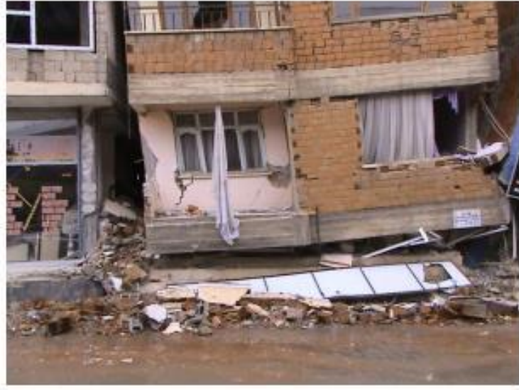
Şekil 2.7. Erciş' te çarpışma sonucu oluşan hasar (Önen vd. 2011)
