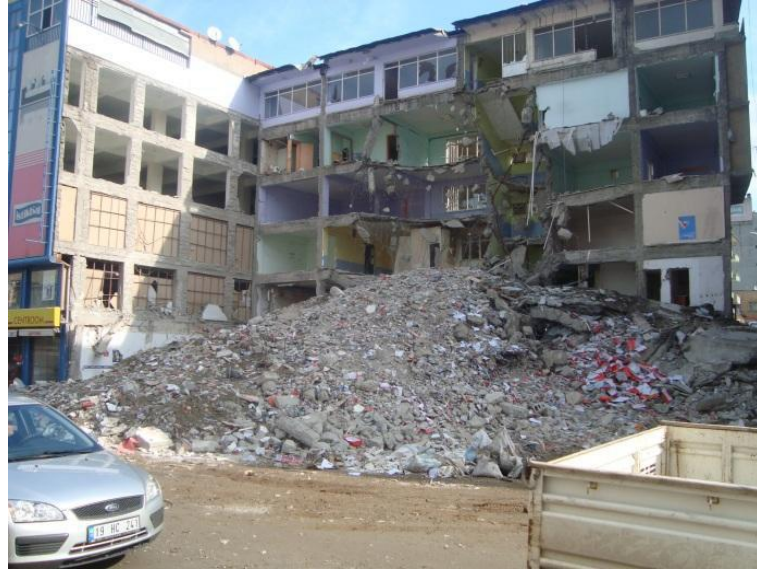
Şekil 2.8. Van İlinde çok katlı bir binanın, yıkılırken dilatasyonla ayrılmış bitişik binaya çarparak verdiği hasar (Önen vd. 2011)
