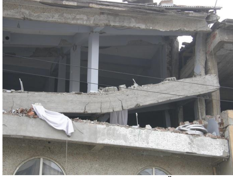
Şekil 2.12. Döşeme-Kolon çarpışması (Önen vd. 2011)
