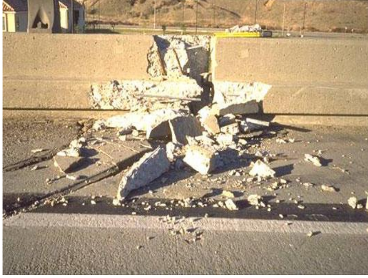
Şekil 2.3. Northridge depremi sonrası hasar örneği
