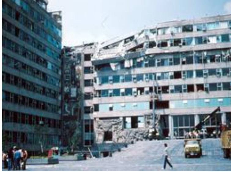
Şekil 2.1. Mexico City depreminde çarpışmadan kaynaklı hasar örneği (Wikispaces, 2015)
