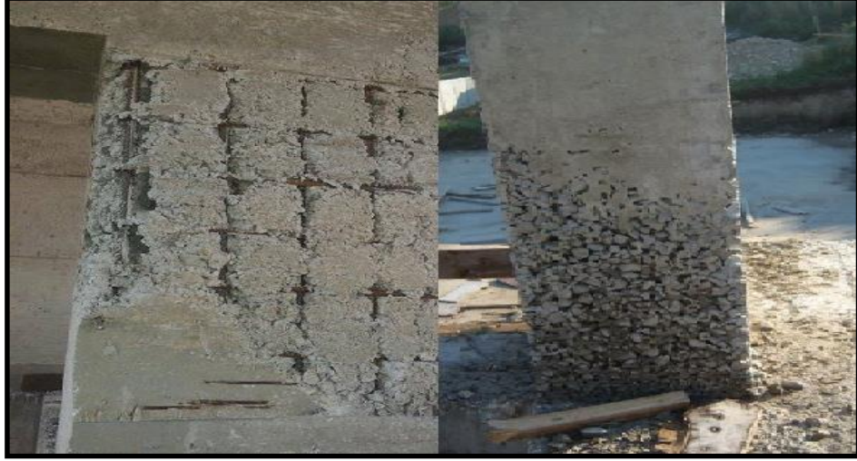
Şekil 2.3. Betonun yetersiz yerleştirilmesi.
